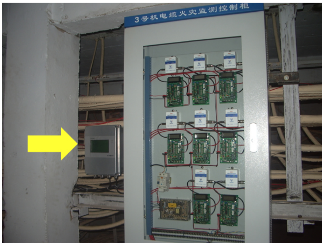
安装于现场的数据采集服务器（右侧是在线监测系统控制柜）
